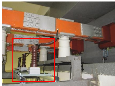
Príklad inštalovaných väzobných kondenzátorov na zbernici generátora
